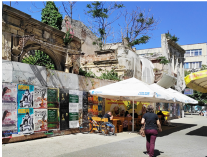
Фиг. 2 Рушащата се жилищно-търговска сграда на Презенти, ул. „Александровска“ 28, ЕНКЦ / Crumbling mixed-use building of Presenti, 28 Aleksandrovskia Str., Listed.
