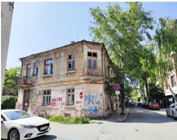
Фиг. 4 Жилищна сграда на ул. „Славянска“ 30/ "Митрополит Симеон" 34, свалена от списъците на НКЦ през 2009г. Днес – обект на вандализъм. / Residential building, 30 "Slavyanska" Str. / 34 "Mitropolit Simeon" Str. Delisted in 2009. Today - an object of vandalism.
