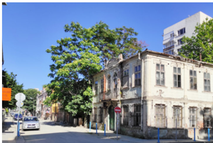
Фиг. 3 Рушаща се жилищна сграда, ул. „Д-р Нигер“ 1 и „Константин Фотинов“ 9, ЕНКЦ / Crumbling residential building, 1 "Dr. Nieder" Str./ 9 "Konstantin Fotinov" Str., Listed.
