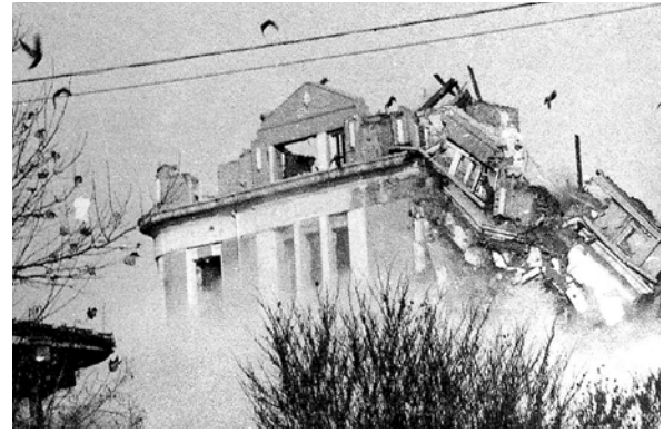
Взривяване на застройката по бул. Княз Борис I в края на 1988 г.
